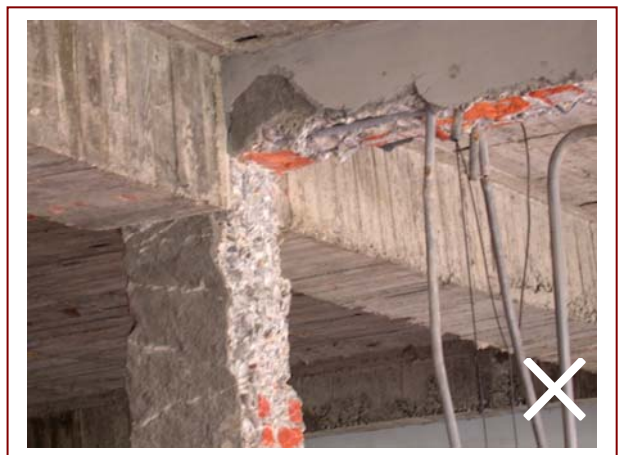
▲ 主要樑柱係屬公寓大廈的共用部分，非經主管建築機關核可並經區分所有權人會議同意，不可擅自削整斷面。
