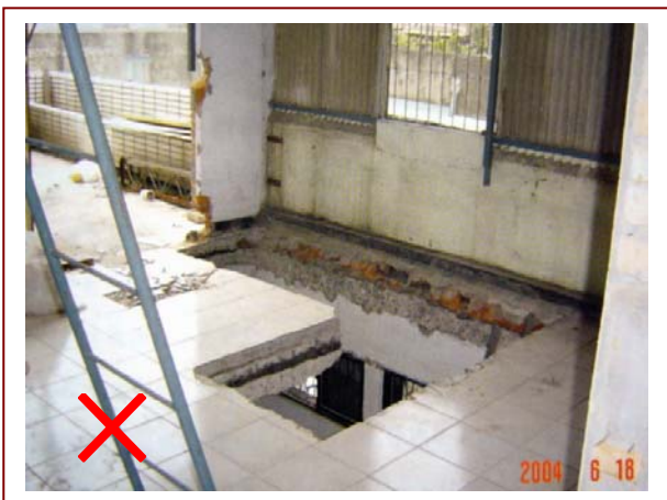
▲ 拆除局部樓版並增設室內樓梯，應依「臺北市一定規模以下免辦理變更使用執照管理辦法」申請變更許可。
