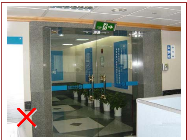
▲ 將防火門擅自更改為玻璃門，形同破壞防火區劃。
