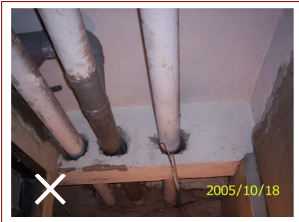
▲ 任意在建築物之主要樑柱穿孔，已涉及主要構造之妨害、破壞。
