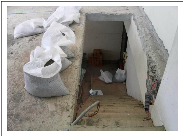
▲ 拆除樓版增設室內樓梯已涉及主要構造之變更，應依法申請變更許可。
