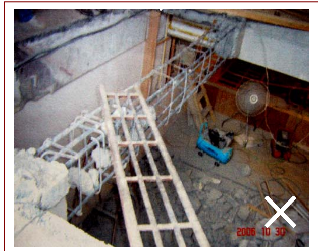
▲ 委託未經登記許可的非法業者進行室內裝修施工，肇致破壞主要構造案例
