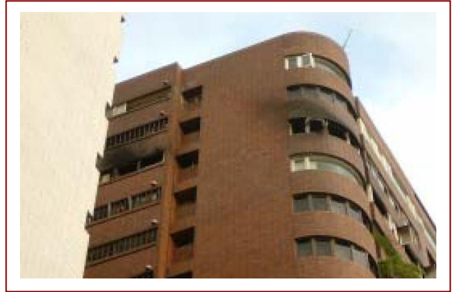
▲ 本市敦化南路某大樓第 16 樓曾因室內裝修施工過程不慎釀成大火案例
