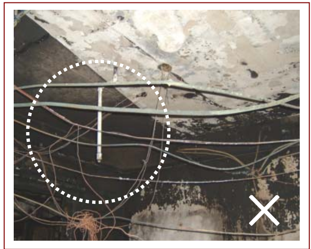
▲ 本市敦化南路某大樓第 16 樓室內裝修施工過程擅自剪斷火警警報系統並封閉灑水頭致災案例
