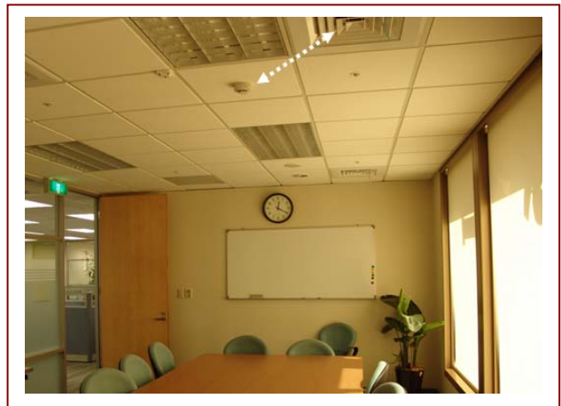
▲ 火警探測器之裝設位置錯誤案例（距離空調出風口至少應達 1.5 公尺以上）
